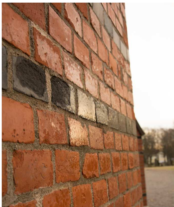
Figur 48. En hydrofoberad yta på Högsäters kyrka där det syns hur vatten pärlar sig på hela tegelytor. Här är dock många vittrade tegelytor som vittnar om att vittringen är en ständigt närvarande process och då är hydrofoberingen inte lämplig eftersom det kan ge ökad vattenbelastning på skadade fläckar.
