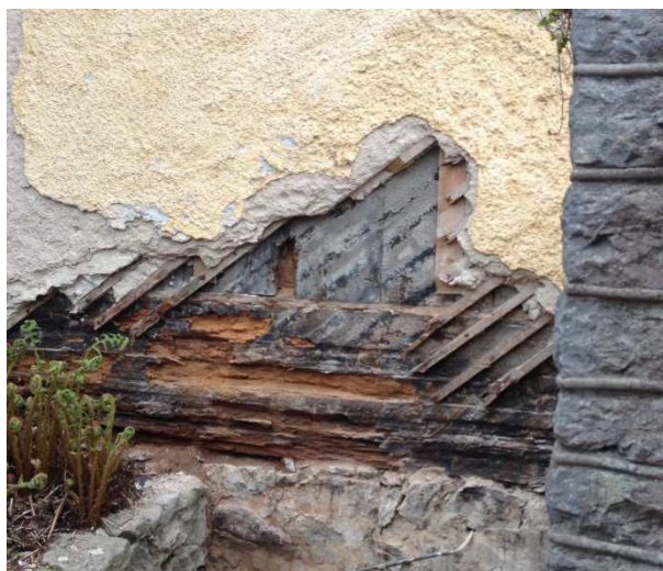
Figur 19. Rötskadad stomme bakom putsskada. Foto: Kristin Balksten
