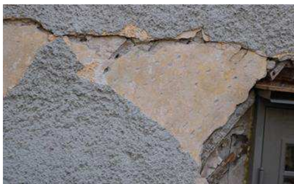
Figur 22. S:t Gertrud 8. Den hårda cementputsen har bitit sig hårt fast i den underliggande spritputsen. Cementputsens och spritningen lossnar i stora sjöar från det släta undre putslagret. Foto: Sofie Nygren
