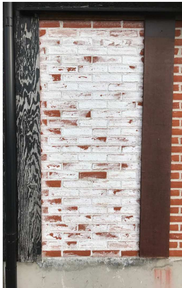
Figur 7. Provvägg A, med det extrema saltinnehållet som syns på ytan.
