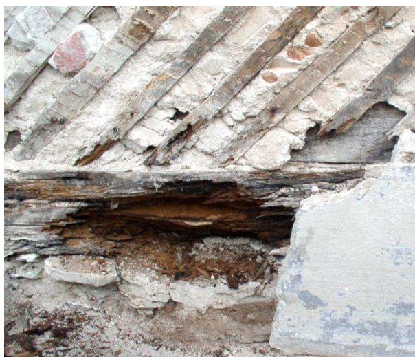
Figur 18. Rötskadad syll bakom tät betongsockel. Foto: Kristin Balksten
