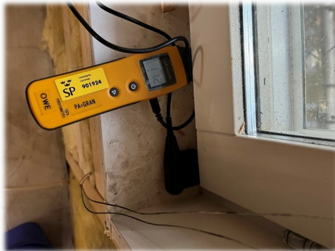
Bild 7 Mätning av fuktkvot i samband med inventering. Oxholmsgatan
