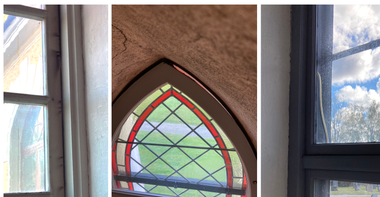
Figur 20 Exempel på läckage i eller i anslutning till fönster. Svärta vid läckage mellan karm och båg i Vätö kyrka (till vänster). Otätt mellan innerglas i egen karm och vägg i Riala kyrka (mitten). Tättningslist som släppt i fönster i Rådmansö kyrka (till höger).
