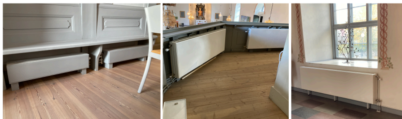
Figur 30 Radiatorer under bänkar, på orgelläktare och under fönster.
