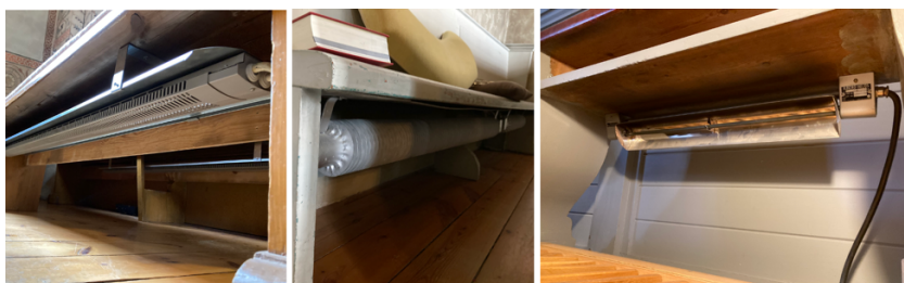
Figur 38 Exempel på bänkvärme under kyrkbänkar och kyrkvärdsbänkar samt kantorsvärme vid orgelpedaler
