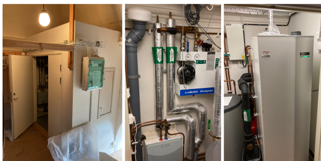
Figur 29 Bergvärmeanläggning i Rådmansö kyrka. Ett vattentätt rum har byggts på vinden.
