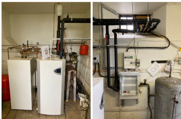
Figur 32 Bergvärmeanläggning för Länna kyrka i en separat byggnad som även rymmer en toalett.
