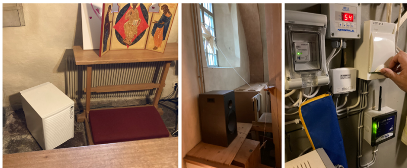
Figur 34 Avfuktare i sakristia och på läktare bakom orgel i platsbyggd låda samt styrning av avfuktare.
