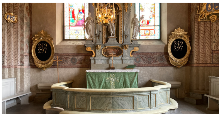
Figur 35 Innerdelar till luft-luft-värmepumpar, på var sin sida om altarringen, har målats för att passa i kyrkans interiör.
