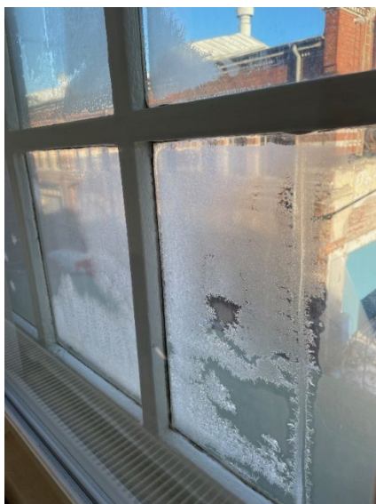
Figur 7: Frostbeläggning på insidan av de yttre fönstren
