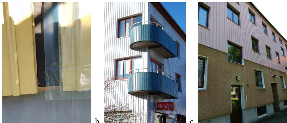
Figur 8. a. Renoverad fasad utan luftspalt som åtgärdas för fuktskador. b. Plåtfasad med detaljering. c. Tilläggsisolerat landshövdingehus med ny fasad av trä och skivmaterial med bristande detaljhantering.
