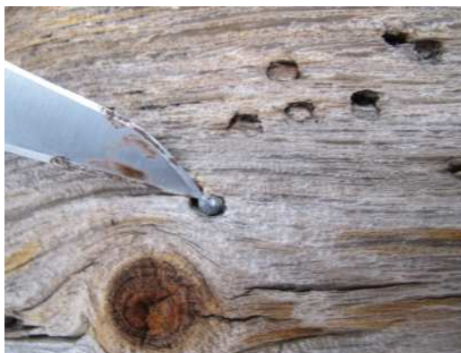
Foto 7. Vid närmare undersökning av denna skada, kunde man se att den inte var orsakad av strimmig trägnagare men av luftgevärskulor.
