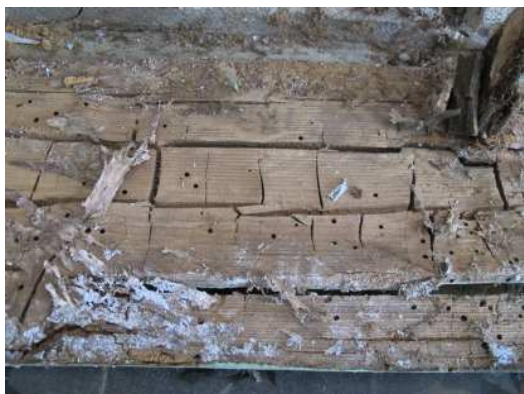
Foto 9. Sekundära angrepp av envis trägnagare visar tydligt att angreppet av äkta hussvamp är gammalt.
