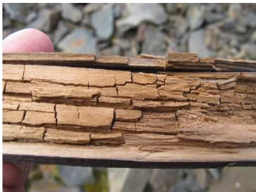
Foto 5. Provtagning är viktig för att kunna bestämma vilken rötsvamp som har orsakat skadan.
