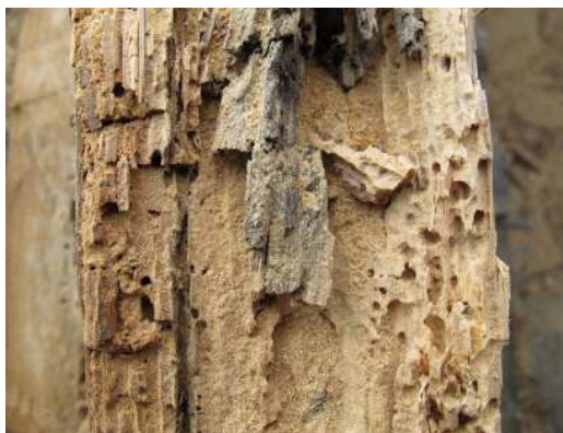
Foto 14. I takytan mot norr vill det med samma takläckage som mot söder, bli bättre livsvillkår för envis trägnagare.
