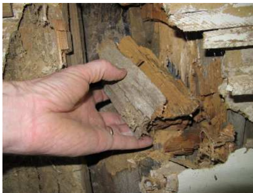
Foto 6. Utseendet på det rötskadade virket kan dessutom ge viktig information om bland annat hur snabbt svampen har växt och utvecklat sig i skadan.
