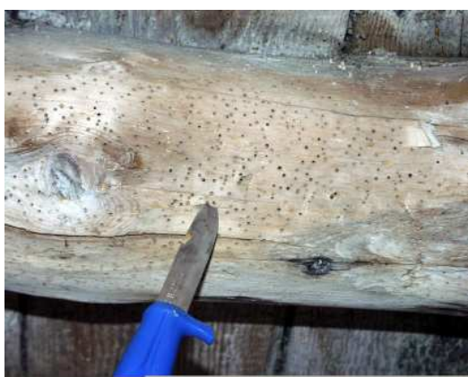
Foto 15. Ett angrepp av strimmig trägnagare betyder inte automatiskt att det är behov för åtgärder. Denna skada är drygt 300 år gammal, och med en likartad skadeutveckling i framtiden kan man anta att det blir behov för reparation om 5-600 år eller mer...
