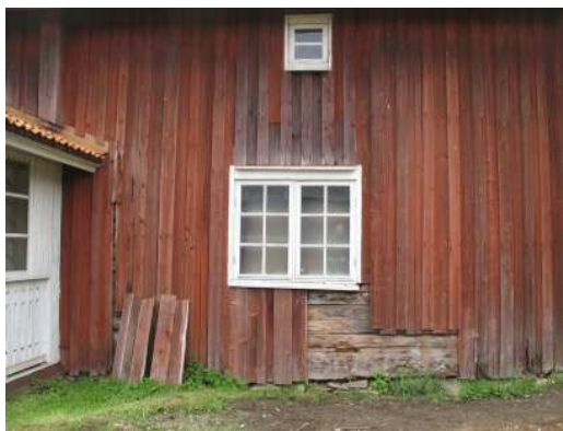
Foto 2. En lokal öppning av panelväggen kan ge viktig information om existerande skador och därmed även aktuella fuktkällor.
