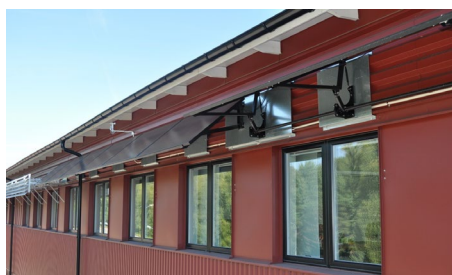
Figur 4 Solavskärmning på plan 2 vid RISE kontor i Borås. Fasta skärmar till vänster i bild och med rörliga moduler till höger.
