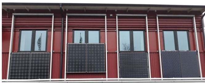
Figur 5 Vertikala moduler för solavskärmning monterade på plan 2. Från vänster till höger: Onyxium 2*290 W p vit polymerbaksida (fönster 1 o 2 från vänster), Onyxium 2*195 W p transparent polymerbaksida (fönster 3), Transparium 2*310 W p transparent glas/glas-modul (fönster 4)
